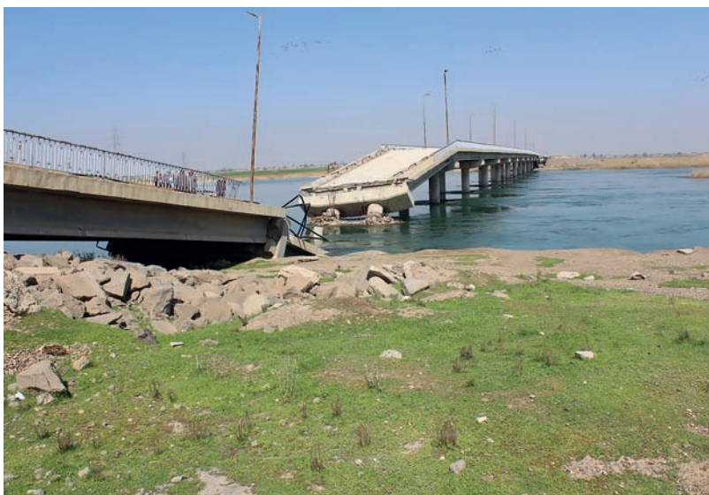
На фото: разрушенный ударами американской коалиции мост в деревне Мукла Кабира, провинция Ракка. Фотография сделана волонтерами Фонда исследования проблем демократии
